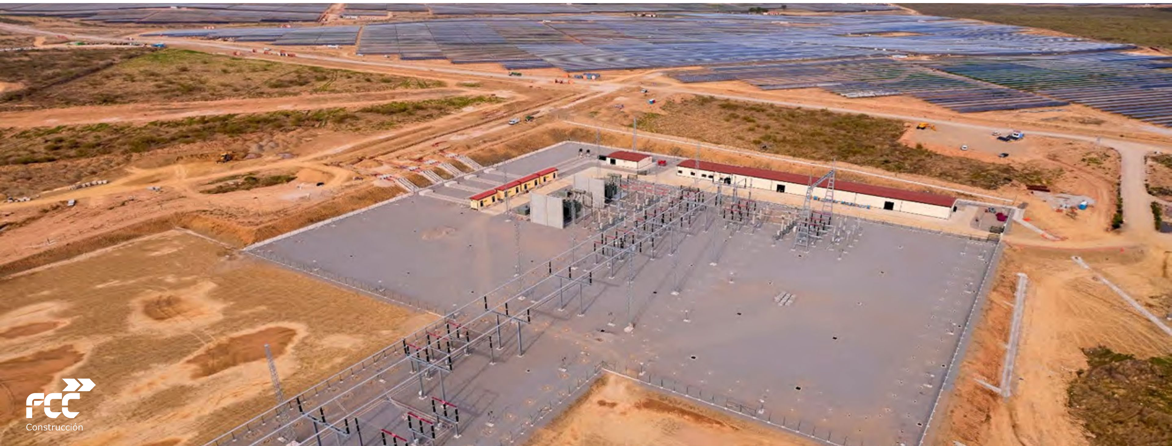
Planta fotovoltaica Pizarro, España
