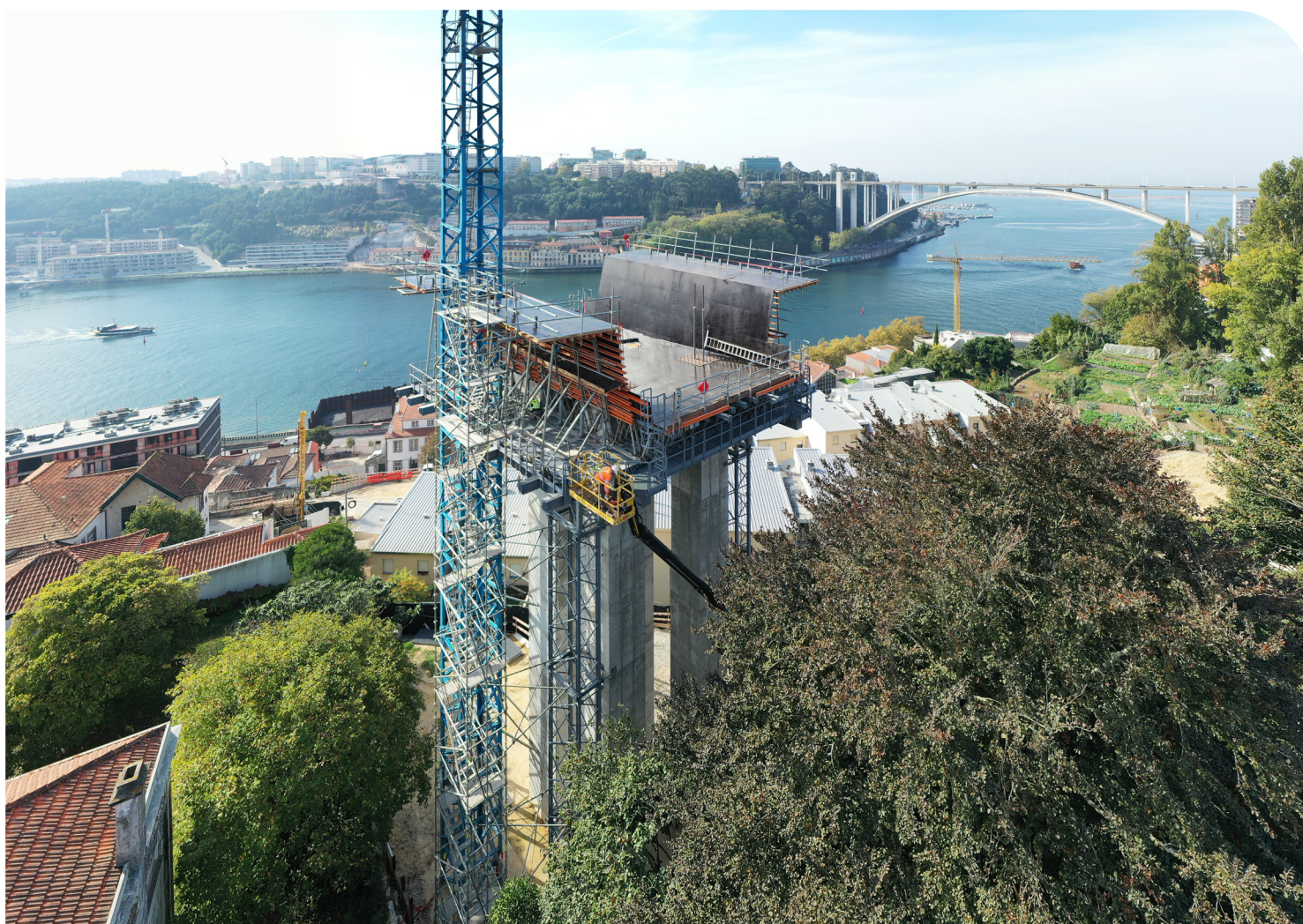
Línea Rubi Metro de Oporto-Ponte Ferreira - Portugal
