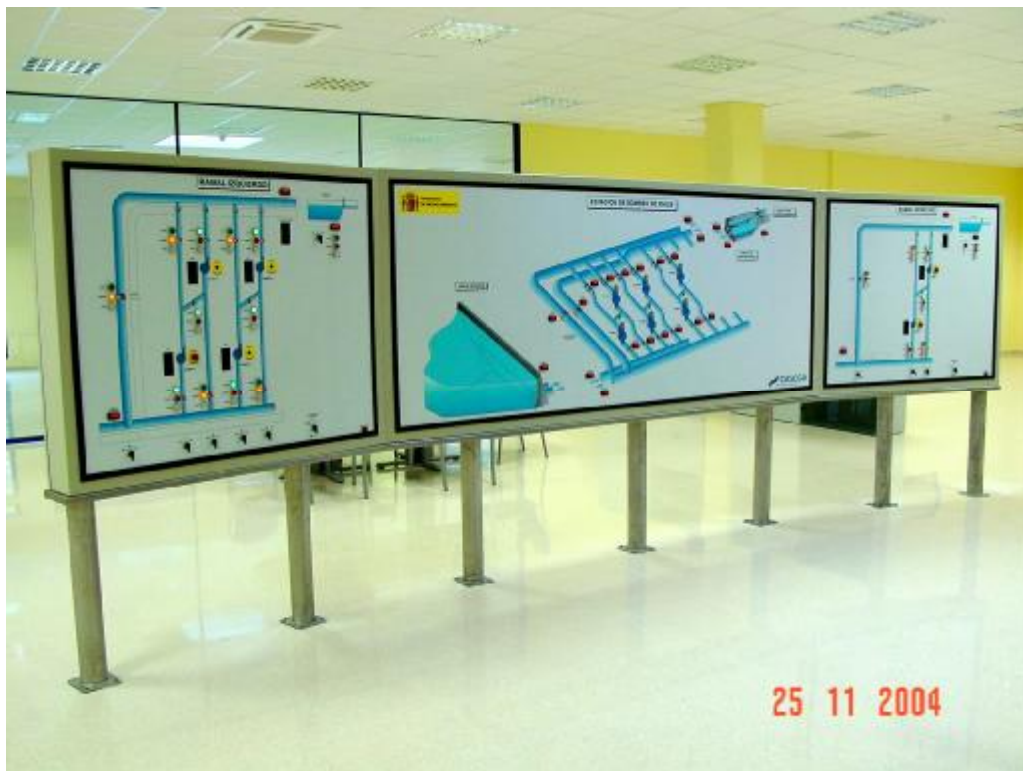
Figura 10. Cuadro sinóptico que integra el sistema de control de la estación de bombeo con los datos de niveles y operación, tanto de la presa como del cuenco de conexión al Canal Segarra-Garrigues
