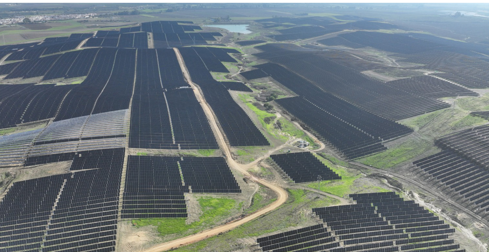
Parcul fotovoltaic Guillena (Sevilla, Spania)
