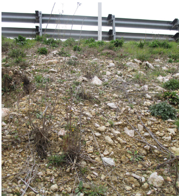
Tierra seca con pérdida de suelo
