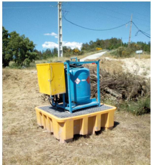
Cubeta de contención de derrames.
