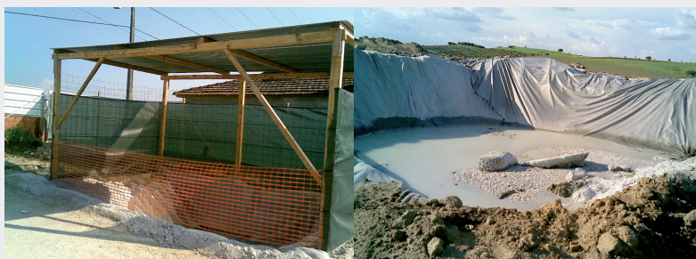
Balsas de lavado de hormigón.
