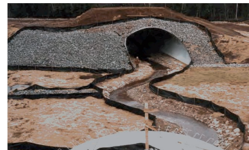
En los casos en que es necesario se emplean barreras filtrantes para la protección de cauces frente a escorrentía superficial, evitando el transporte de finos procedentes del entorno y el incremento de la turbidez del agua.
