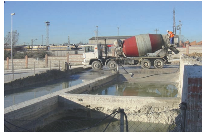
El agua procedente de las obras suele llevar sólidos en suspensión y aceites emulsionados o en flotación. Una técnica adecuada y eficaz para su tratamiento son las balsas de decantación con deflectores, donde decantan los sólidos y se separan los aceites por flotación.
