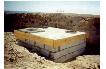
Por pequeño que sea el caudal de las aguas de saneamiento, nunca se deben verter directamente. Por ello, en las obras de FCC se establecen fosas sépticas o depuradoras portátiles, solicitando las autorizaciones de vertido correspondientes y analizando periódicamente la calidad de los vertidos.
