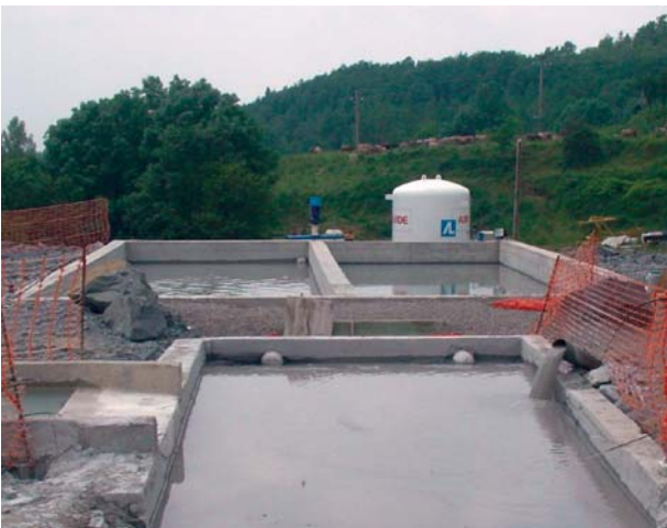
La salida del efluente se decanta inicialmente antes de pasar a las balsas de neutralización mediante dióxido de carbono situadas a la salida del túnel, eliminando S.S. y reduciendo el pH
