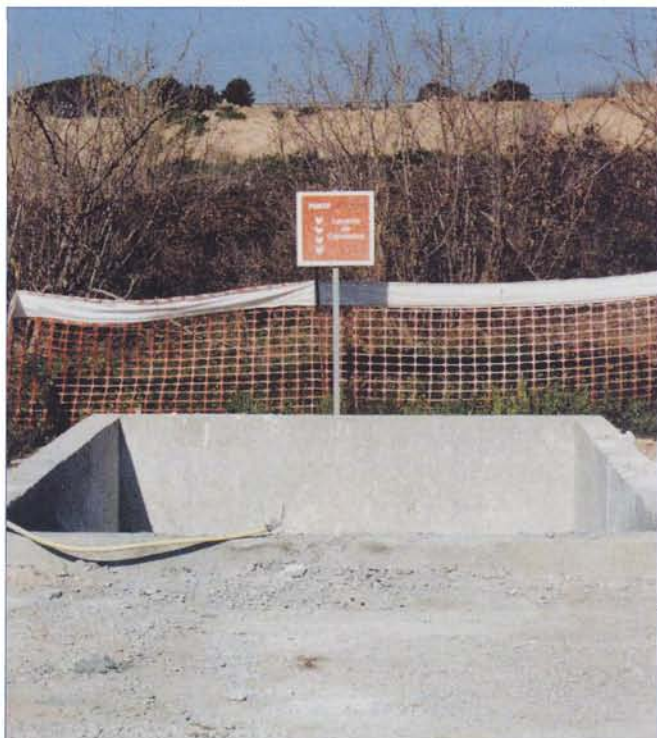
El agua de lavado de cubas y canaletas, con un pH muy elevado, es sistemáticamente neutralizada en balsas previamente a su vertido, cuando no puede volver a la Planta de fabricación,
