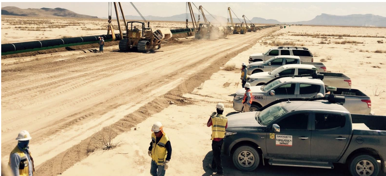
Gasoducto Samalayuca. Sásabe, México.
