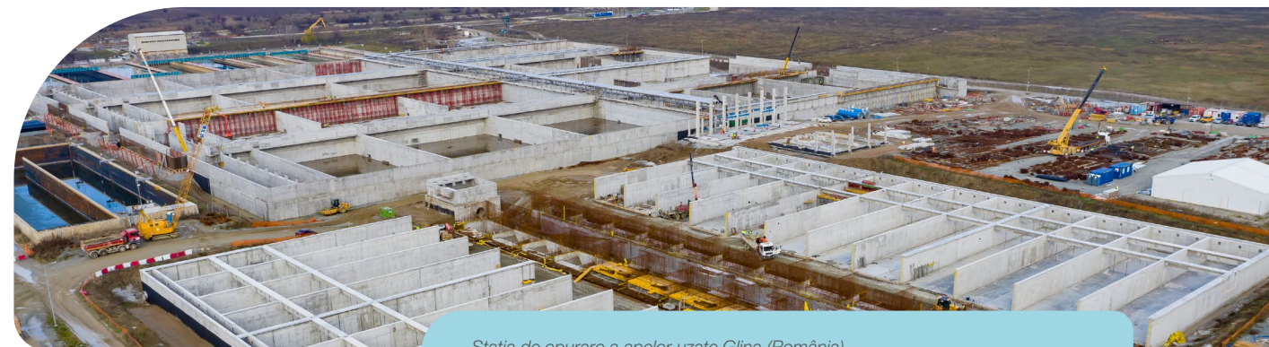
Stația de epurare a apelor uzate Glina (România)
