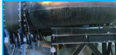
Operación, Mantenimiento y Asistencia técnica
