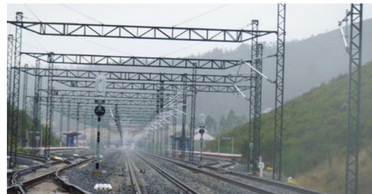
Catenaria alta velocidad eje Atlántico
